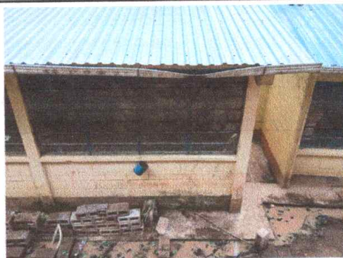
Foto 4: CANALES DE BAJAS DE AGUA PLUVIAL DE PVC
